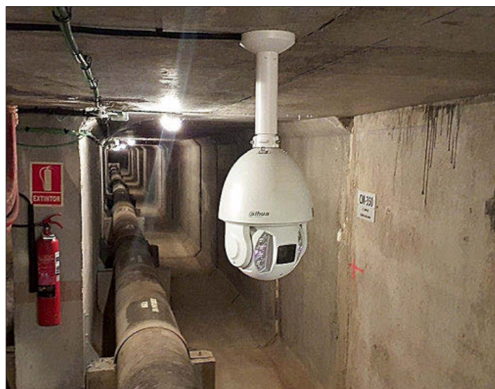
Una cámara bajo tierra detecta cualquier presencia en galerías.
